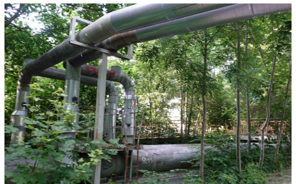
Fernwärmeverteilung in der ganzen Stadt
